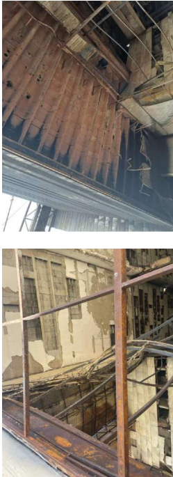
Detalle de afecciones en elementos estructurales interiores
