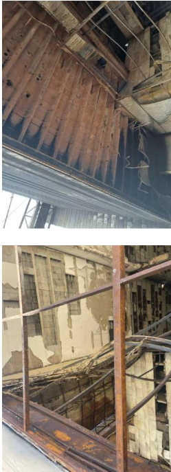
Detalle de afecciones en elementos estructurales interiores
